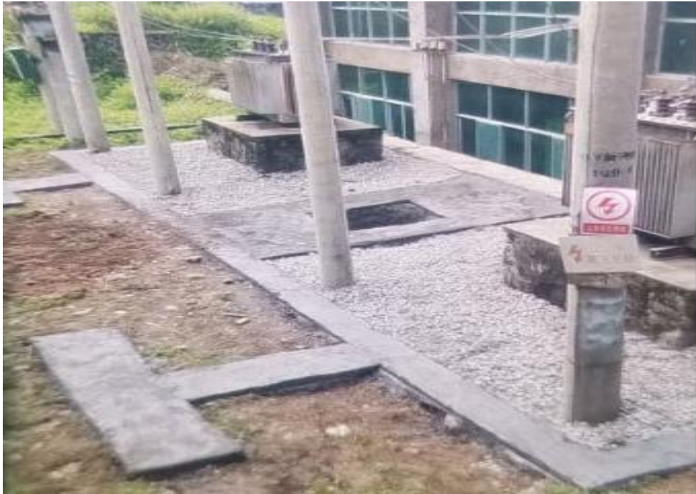
变电站围堰、事故池
