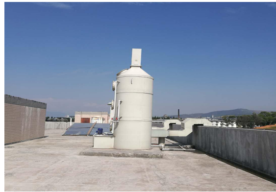
无机废气酸雾喷淋塔
