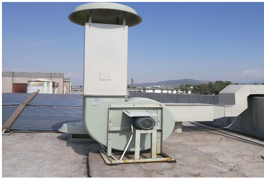
有机废气 排气管
